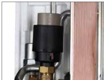
Reguleringsventil til brugsvandstemperatur.
